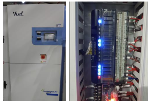
제습기 컨트롤 패널 연계 설비 신호 취득
