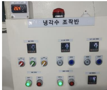
용접로봇 냉각수 조작 데이터 정보 취득 및 MES연계
